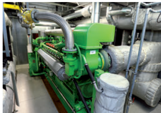
Cogeneratore accoppiato a una pompa di calore a Bad Lauterberg, azienda di pubblica utilità.
